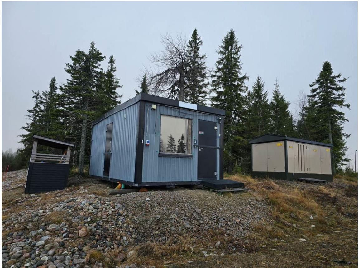
Kuva 9 Teknisen huollon tila ja puistomuuntaja
