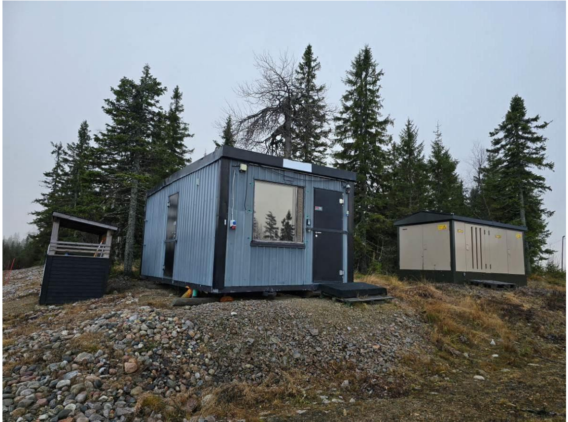
Kuva 9 Teknisen huollon tila ja puistomuuntaja
