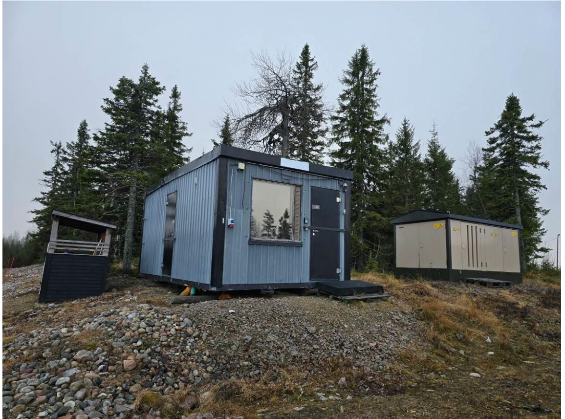
Kuva 9 Teknisen huollon tila ja puistomuuntaja
